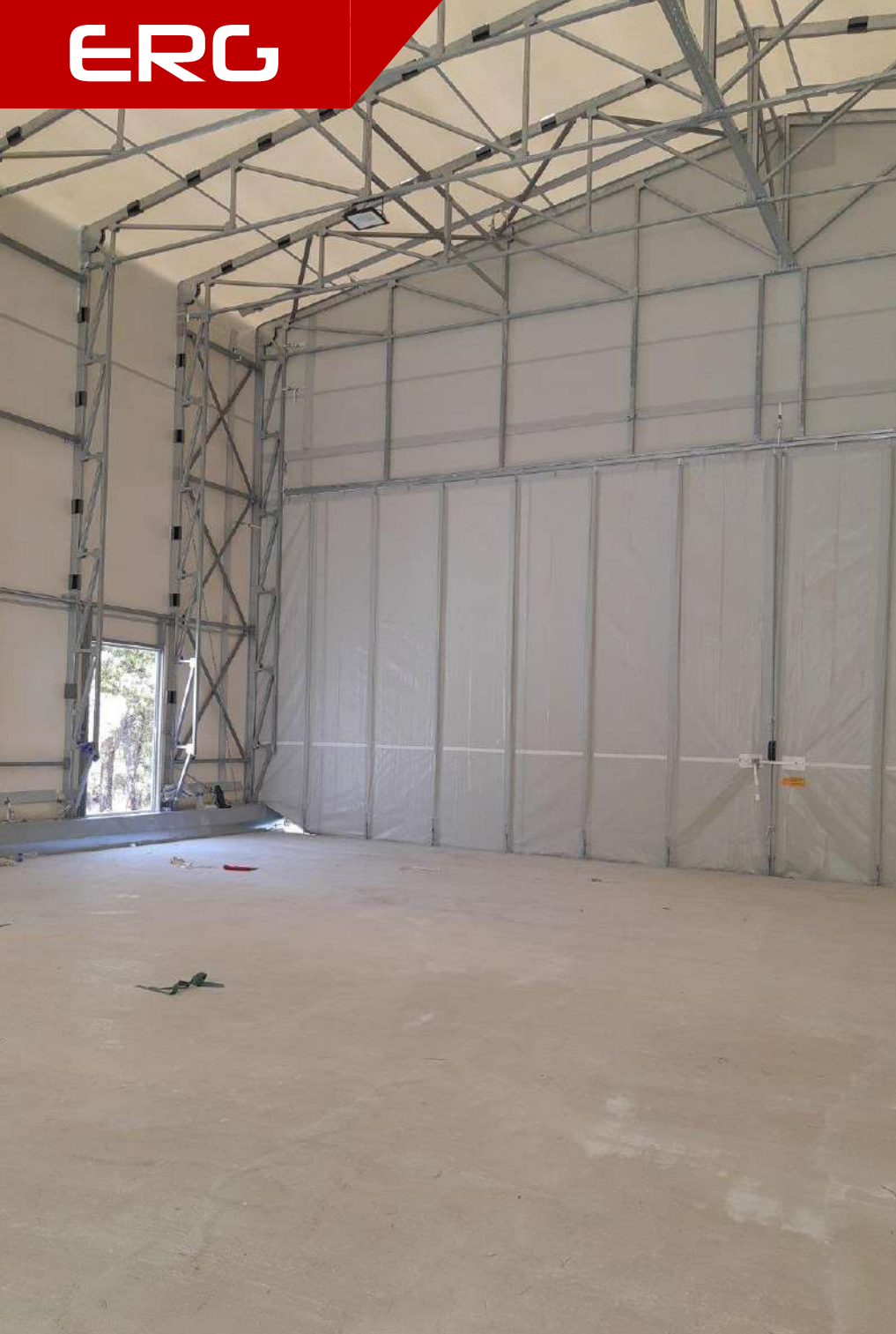
Εσωτερικό του κτιρίου, με την πόρτα ασφαλείας.
