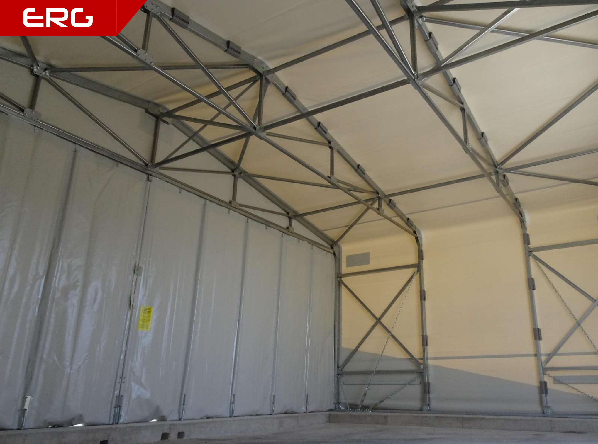
Εσωτερικό του κτιρίου με άποψη του συστήματος κίνησης.
