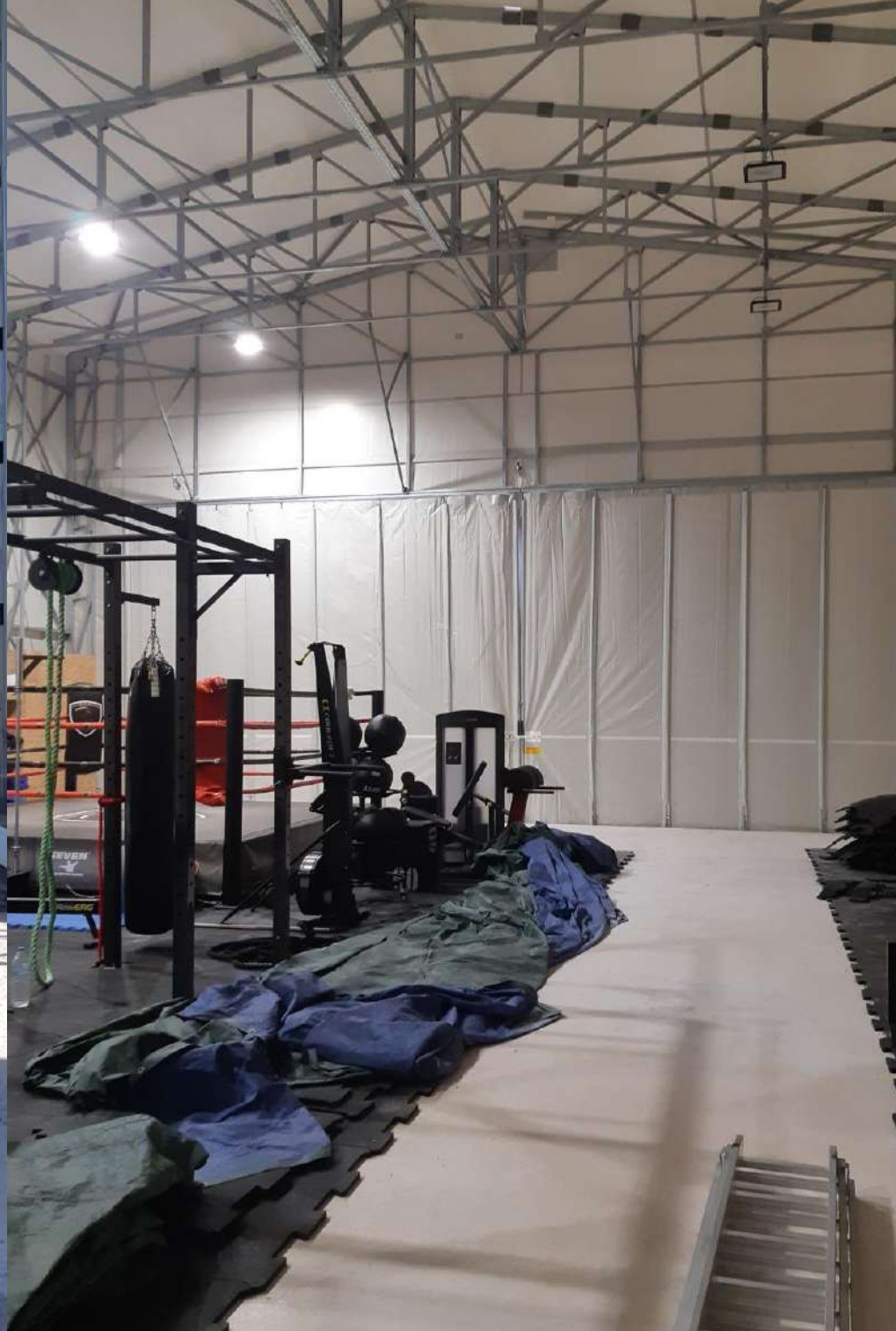
Εσωτερικό του κτιρίου με εγκατεστημένο σύστημα φωτισμού.
